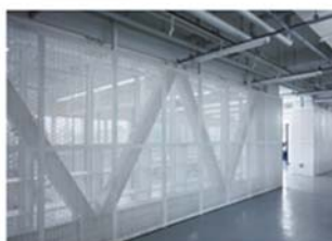
耐震ブレースと展示壁
