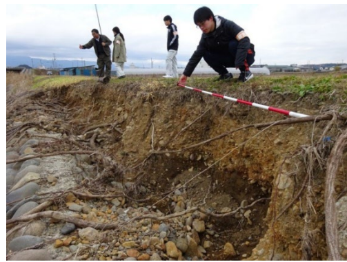
令和元年東日本台風の被害調査
